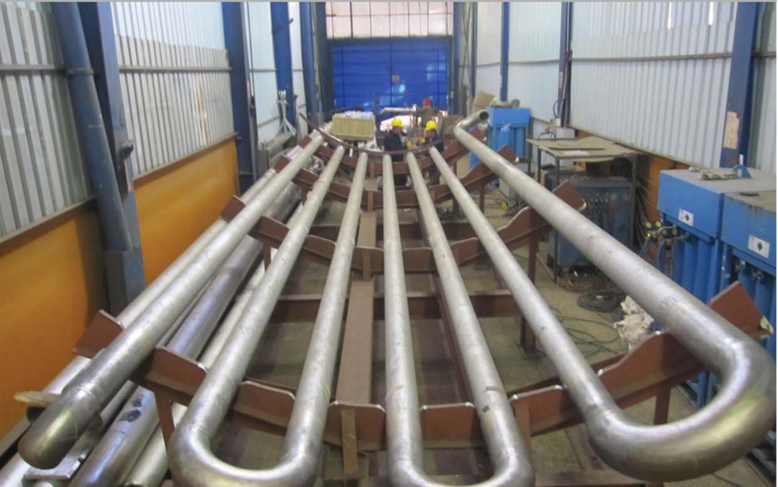
TR - TÜPRAŞ PIPING
